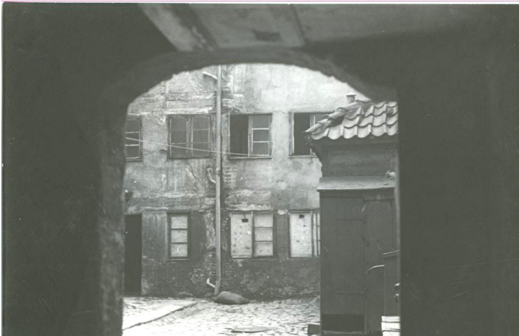
Baggård fra Borgergade i 1958, der giver et indtryk af hvordan forholdene har været.
